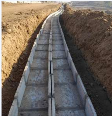
L&T Cable Trenches
